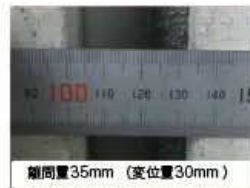
離間量35mm (変位量30mm) 地震動により離間した状態
